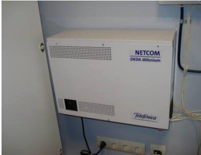
Sistema d'intercomunicació telefònica
